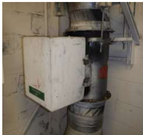
Existing exhaust fan
